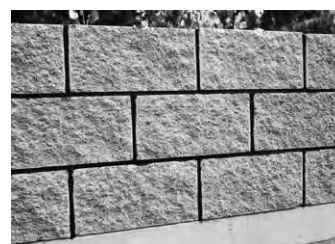
HOTOVÉ ZDIVO: při precizním uzavření spár jsou spoje odolné vůči povětrnostním vlivům a mrazu a konstrukce po vyzrání výplňového betonu působí jako jeden monolitický celek.
